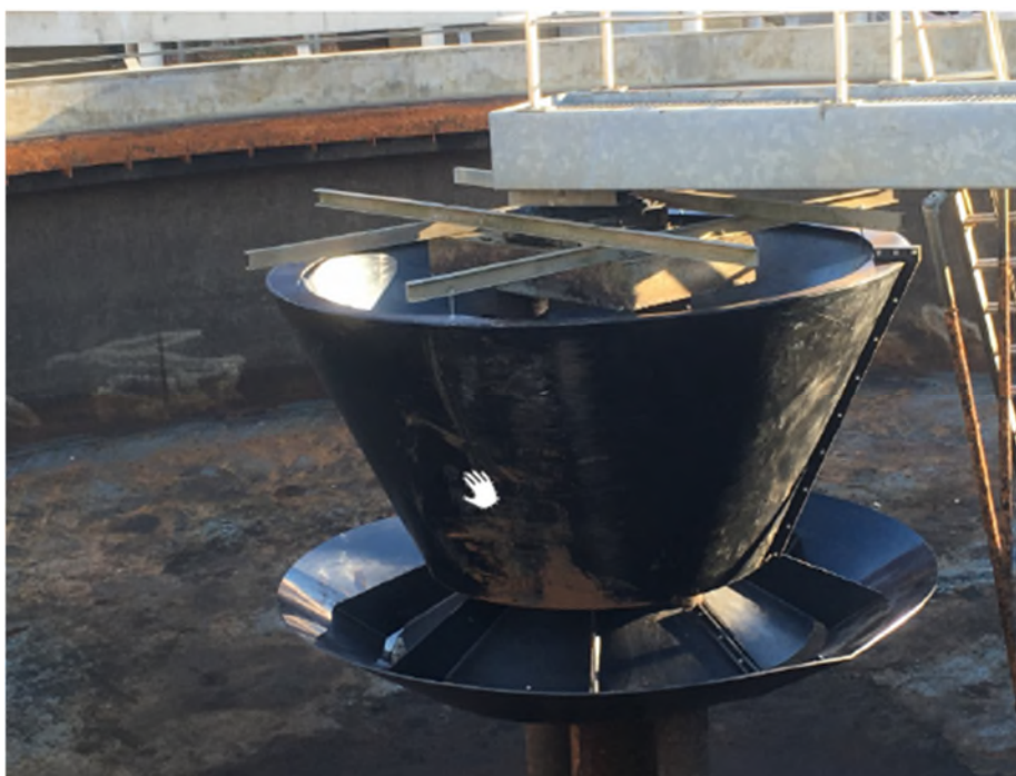
Figure 21 : Photographie de l'installation sur la STEU de Feurs
