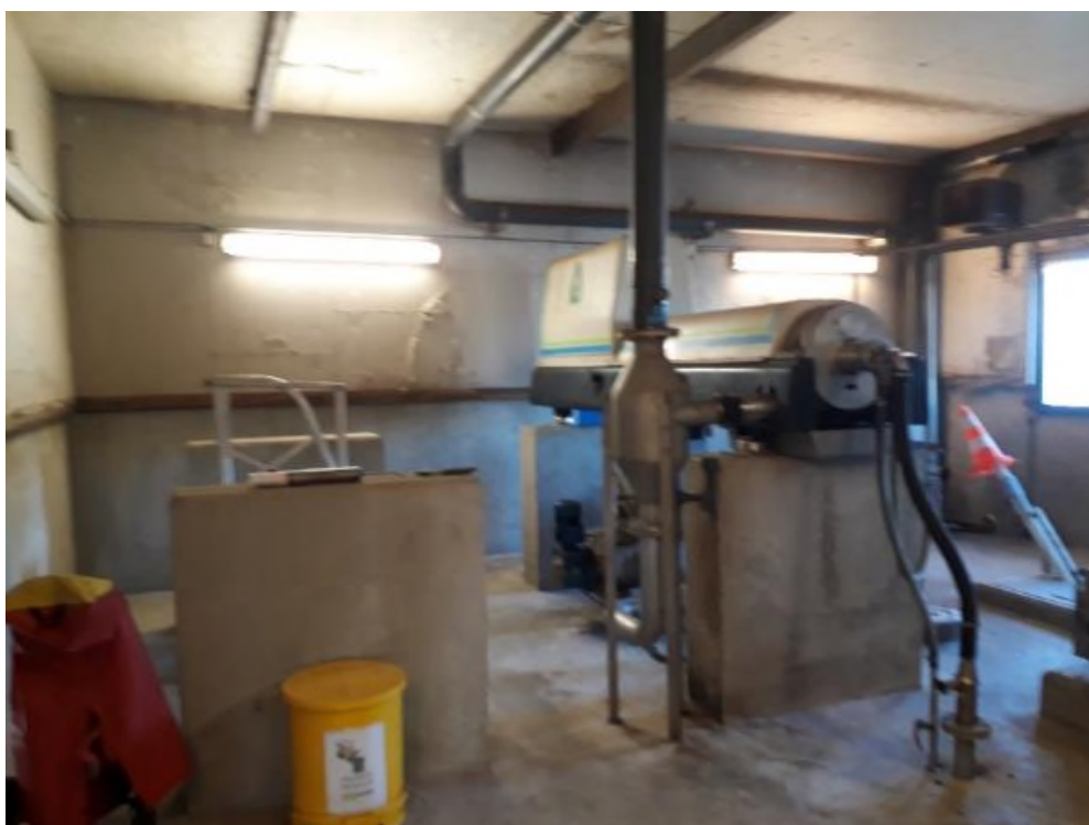
Figure 23 : Photographie de la zone de déshydratation des boues
